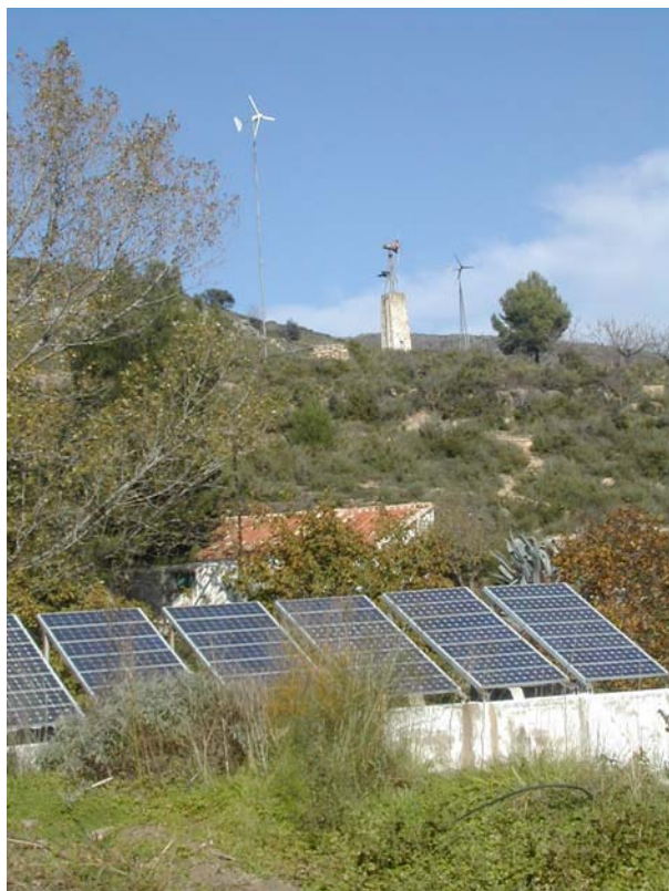
Campo fotovoltaico, en primer término, y aerogeneradores, al fondo
